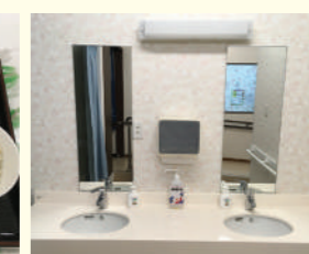
清潔に保たれた施設設備。
